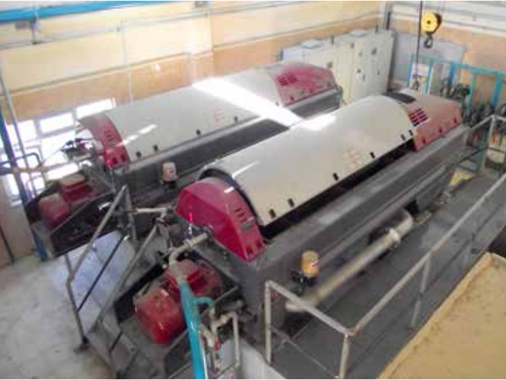
Çamur Susuzlaştırma Üniteleri (Dekantörler)
